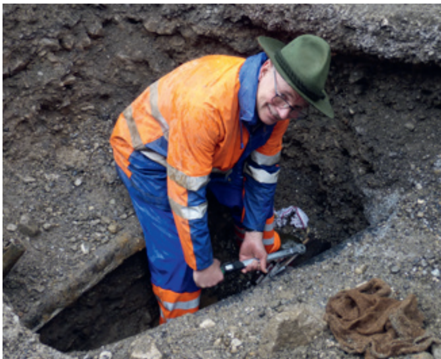
Brunnenmeister Hans Barmettler beschäftigt mit dem Wasserleitungsbruch an der Beckenriederstrasse 11
