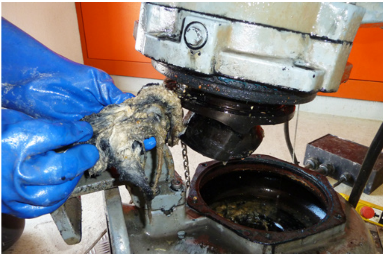
Reinigungs-, Feuchttücher und Textilien verstopfen die Abwasserpumpe Hobiel in Buochs
